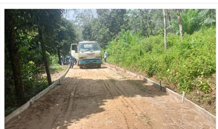
(๔) โครงการก่อสร้างถนนคอนกรีตเสริมเหล็ก สายไอร์ลูโป๊ะ หมู่ที่ ๖ เบิกจ่าย ๗๗๕,๐๐๐ บาท
